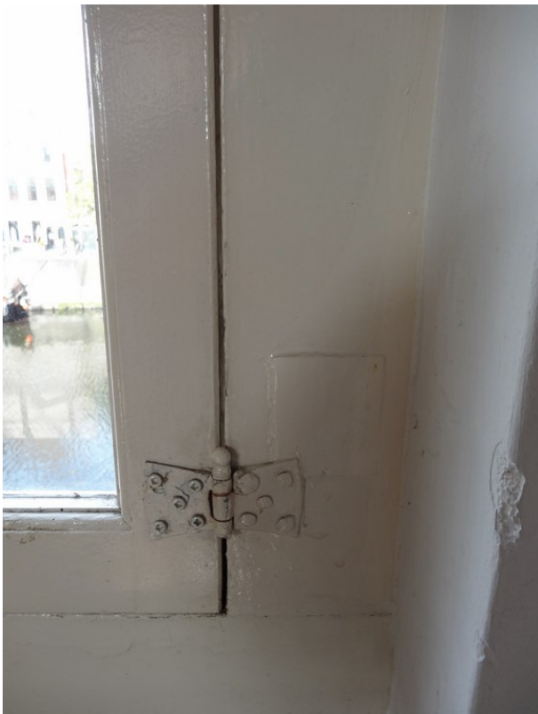
Afb. 45: Scharnier van draaiende onderramen, die gezien de afwijkende bevestigingen op de vleugel links moet zijn vervangen. Naast de rechter vleugel is een afdichting te zien van de bevestiging van het duim, waarop het luik aan de buitenzijde draait.
