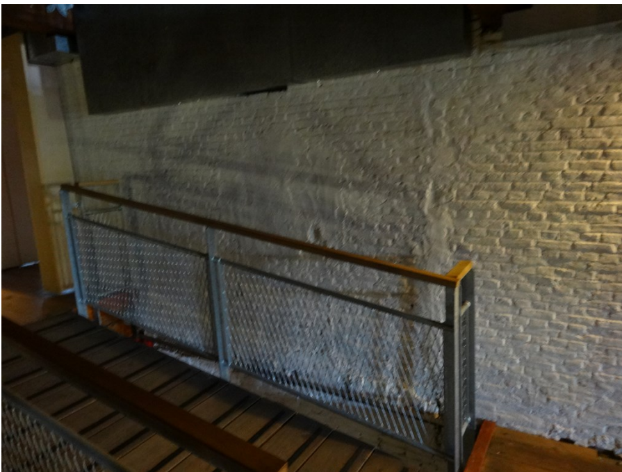
Afb. 36: Vervolg van de muur op de vierde bouwlaag boven de dichtzetting op de derde bouwlaag. in de ruw gepleisterde herstelling bevindt zich een scheur, als gevolg van de verzakking aan de oostelijke zijde van het pakhuis. Waarschijnlijk bevond zich hier de tussengevel als scheiding tussen het drie bouwlagen hoge oostelijke gedeelte en het vier bouwlagen hoge westelijke gedeelte.
