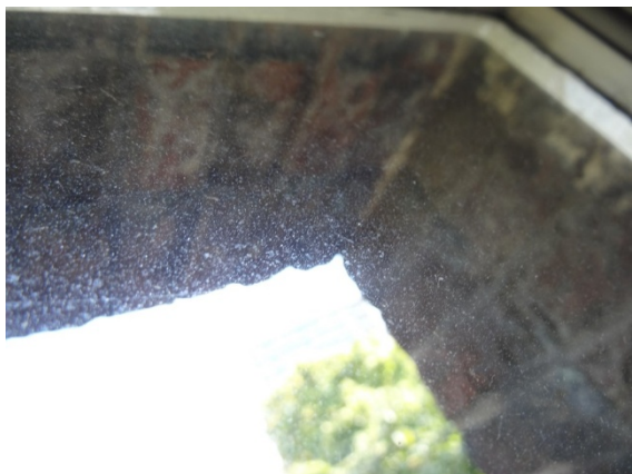
Afb. 22: Dagkant van een 4-rruits raam, waarin de schilderlijn zichtbaar is.
