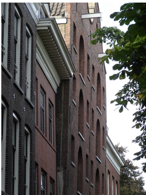
Afb. 21: De naar voren hellende oostelijke gevel. De verticale naad staat open.
