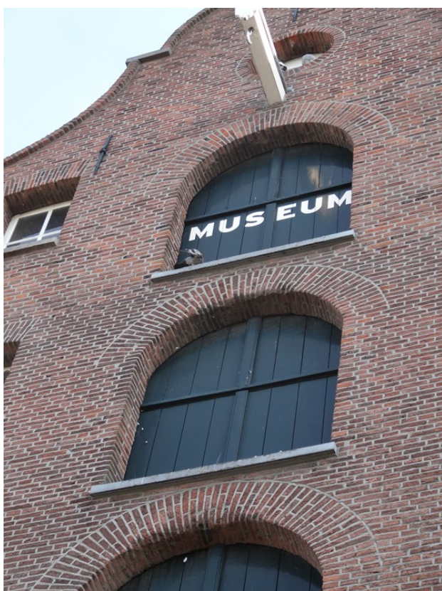
Afb. 13: Centrale vensteras in het noordelijke gedeelte van de gevel. De twee onderste rondbogen zijn afgerond gesleten door het hijswerk en slaan van touwen.
