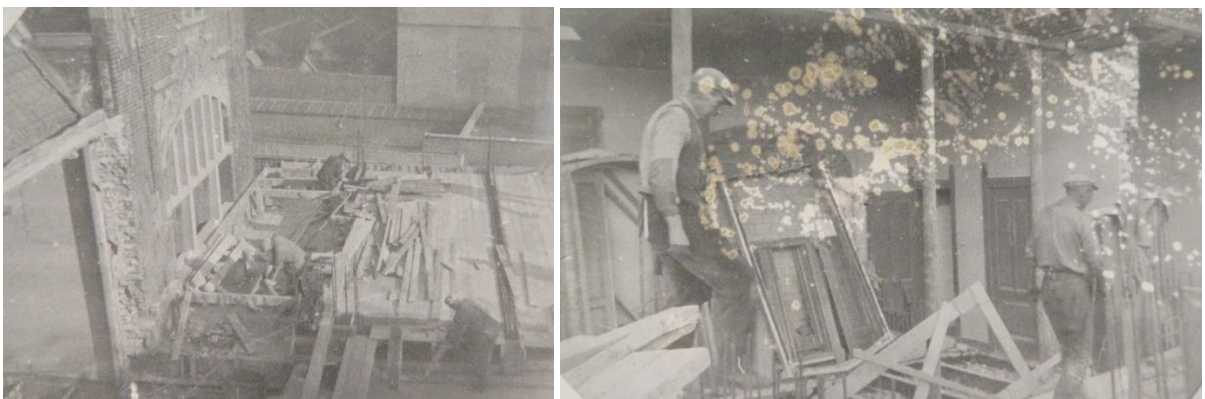
Najaar 1931; aanbrengen eerste verdiepingsvloer en het uitbreken van de gevel en achterliggende indeling van het bestaande kantoorgebouw. (Heinekencollectie)
