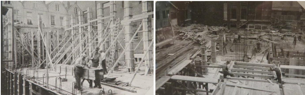
Najaar 1931; het oprichten van de kolommen op niveau van het souterrain en de bel-etage. (Heinekencollectie)
